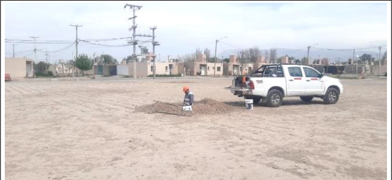
Fotografía N°10: Vista de la posición en el terreno de la Calicata C.3 . Se observan los trabajos de excavación y toma de muestra.
