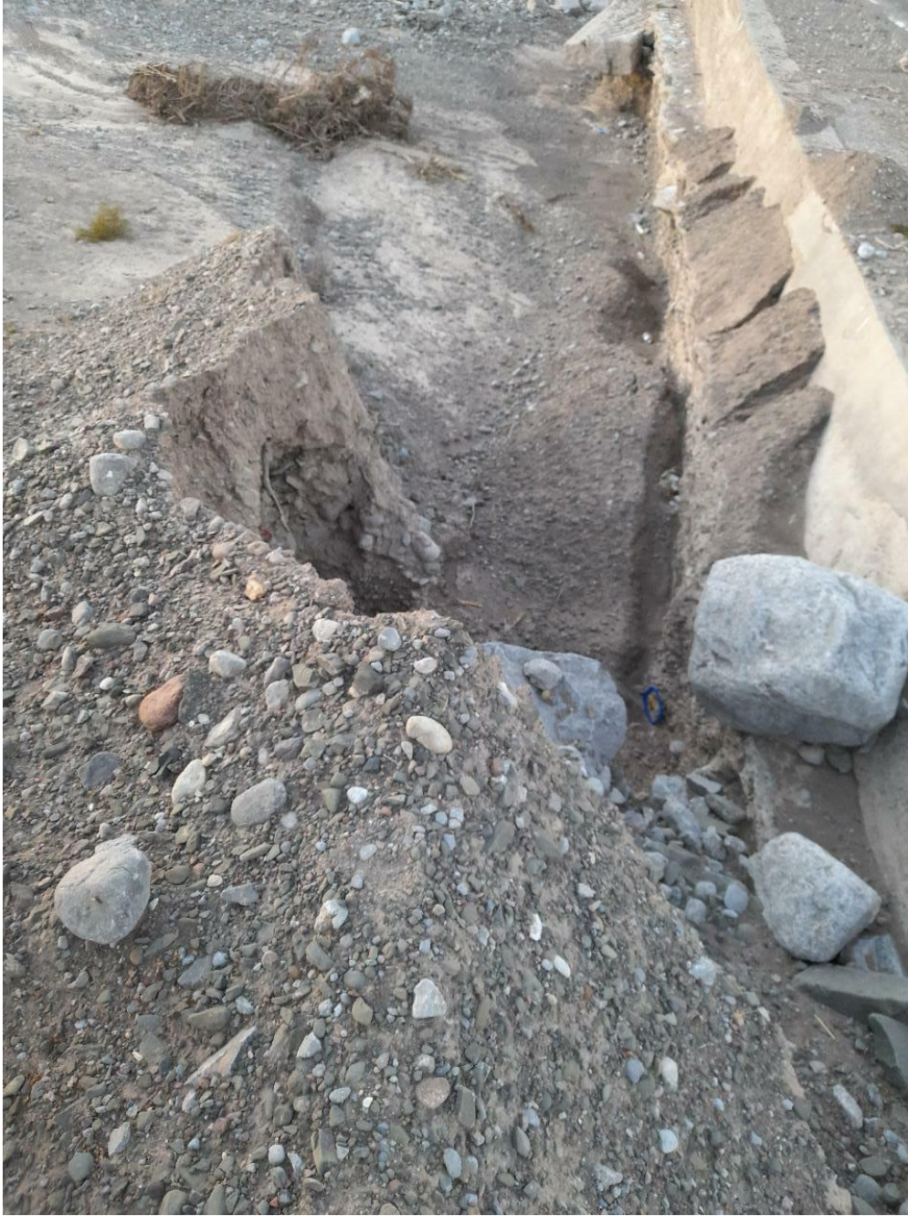
Foto: Badén N°2 Socavación Aguas- Abajo.
