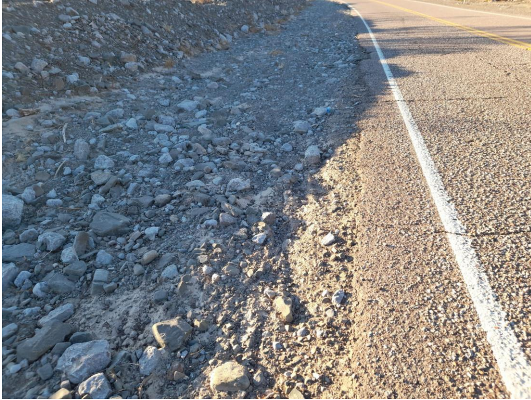
Foto: Estado general de banquetas.
