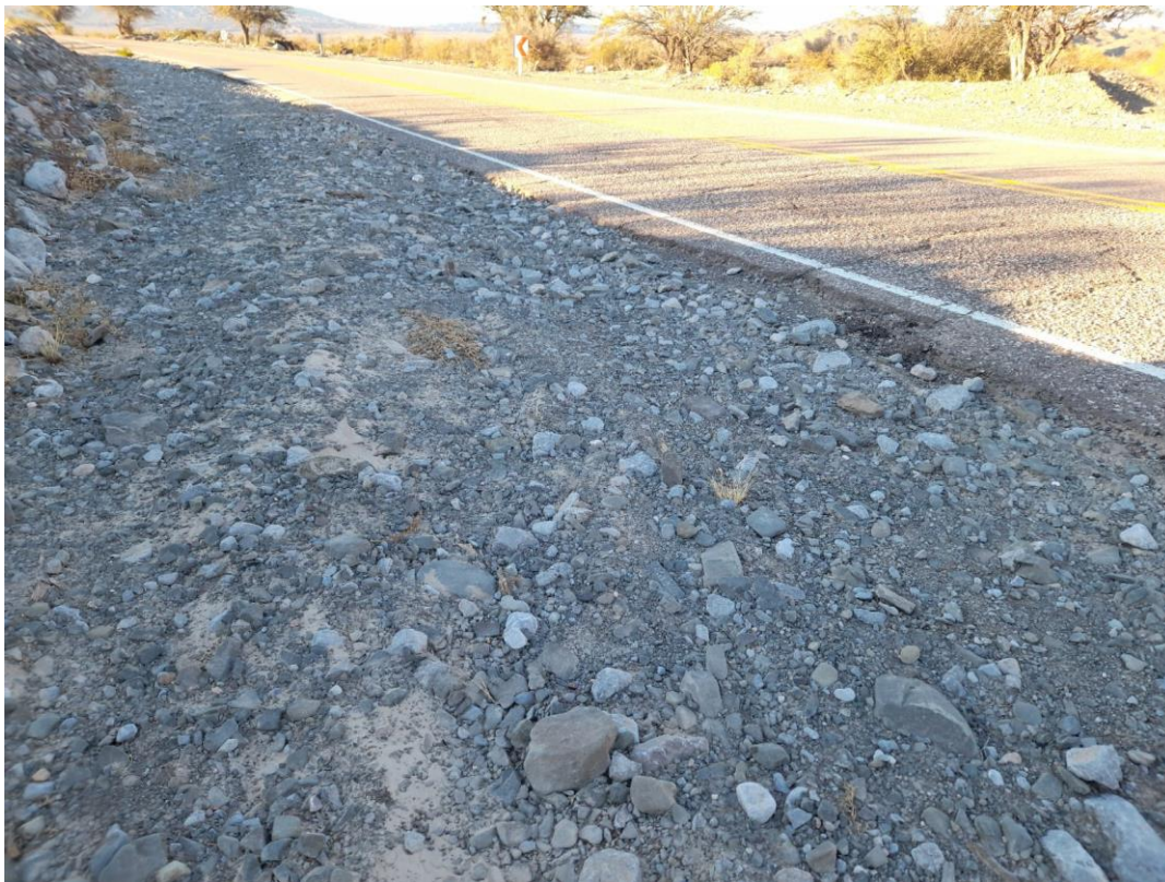
Foto: Estado general de banquetas.
