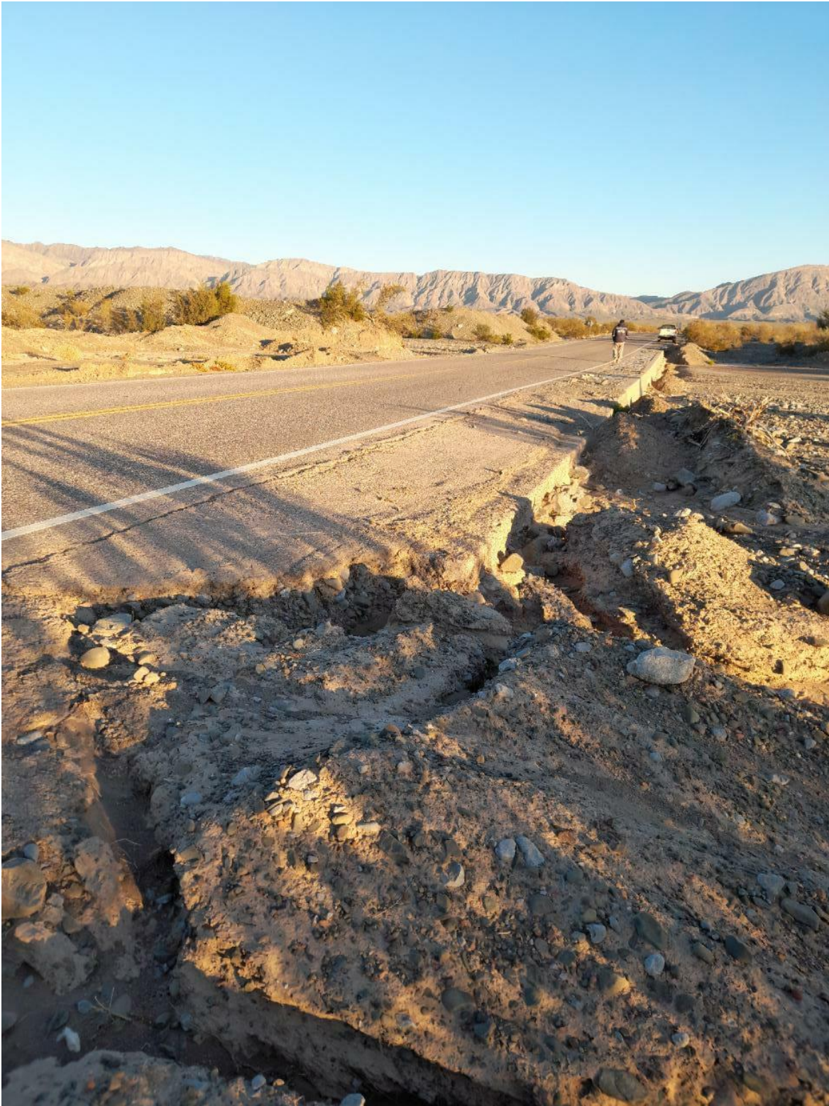
Foto: Badén N°4, Prog. 5+500, deterioro de banquinas.
