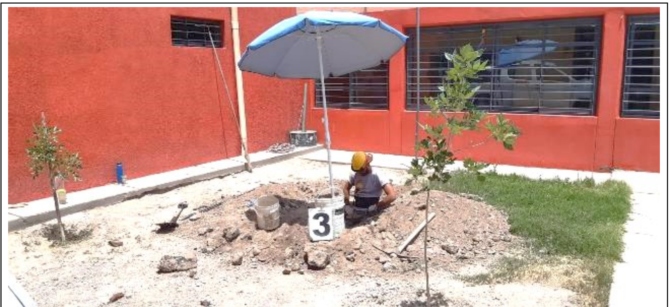
Fotografía N°7: Vista de la posición en el terreno de la Calicata C.3. Se observan los trabajos de excavación y toma de muestra
