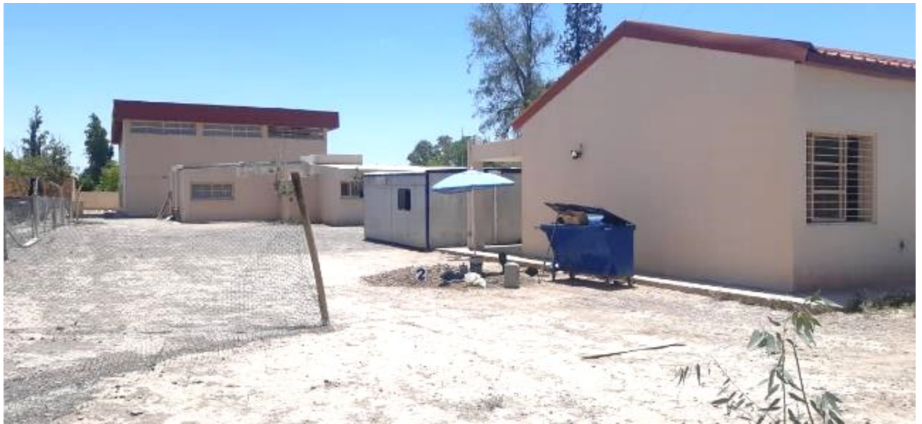
Fotografía N°3: Vista de la posición en el terreno de la Calicata C.2. Se observan los trabajos de excavación y toma de muestra.
