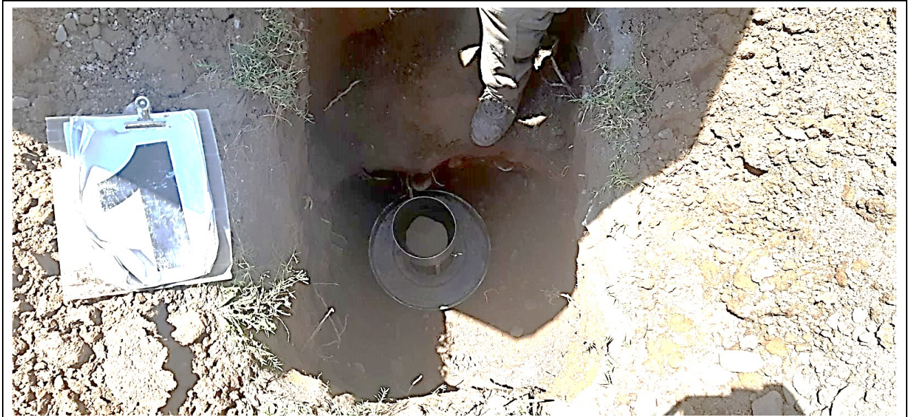
Fotografía N°7: Calicata C.1. Se muestra el ensayo de densidad in situ por el método del cono y la arena (Norma DNV) a la profundidad de 1,30m en el estrato granular grueso formado por una grava arenosa. Se muestra el perfil estratigráfico de suelos formado por un estrato superior de limo arenoso de 0,90m de espesor y subyacente comienza el estrato granular grueso del cono aluvial del Río San Juan formado por una grava arenosa.
