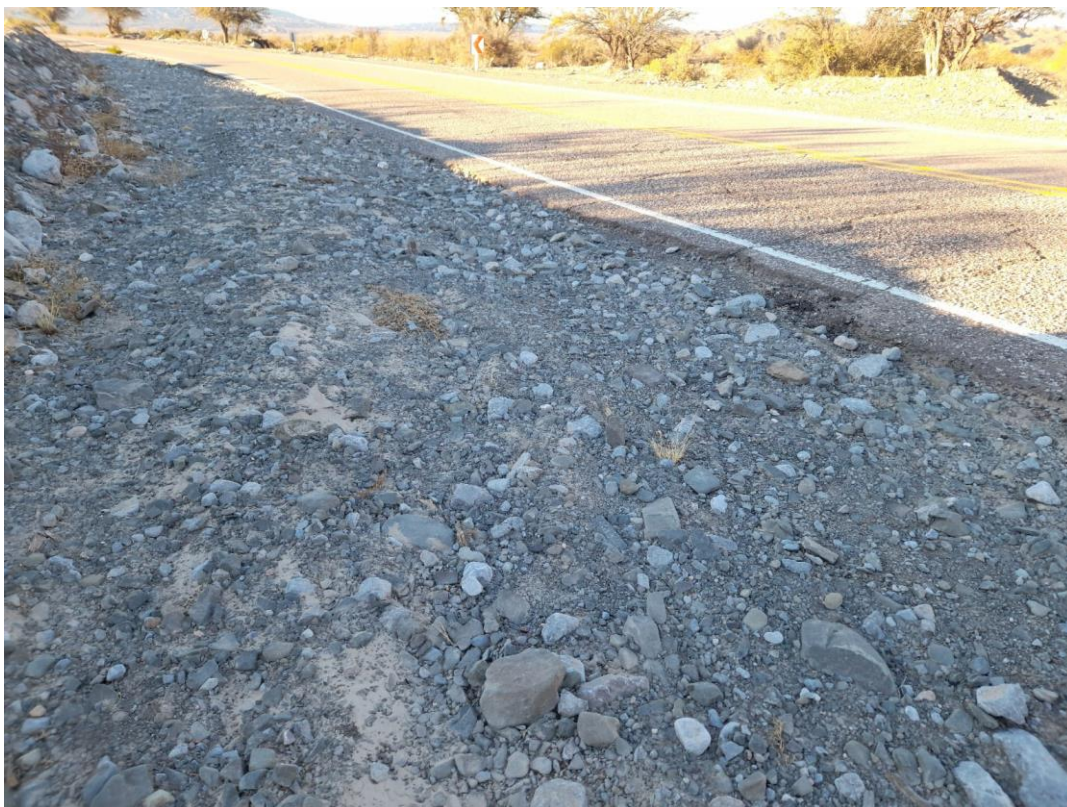
Foto: Estado general de banquetas.
