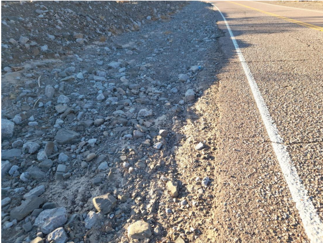
Foto: Estado general de banquetas.
