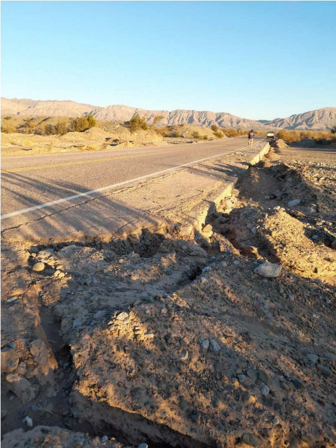
Foto: Badén N°4, Prog. 5+500, deterioro de banquetas.
