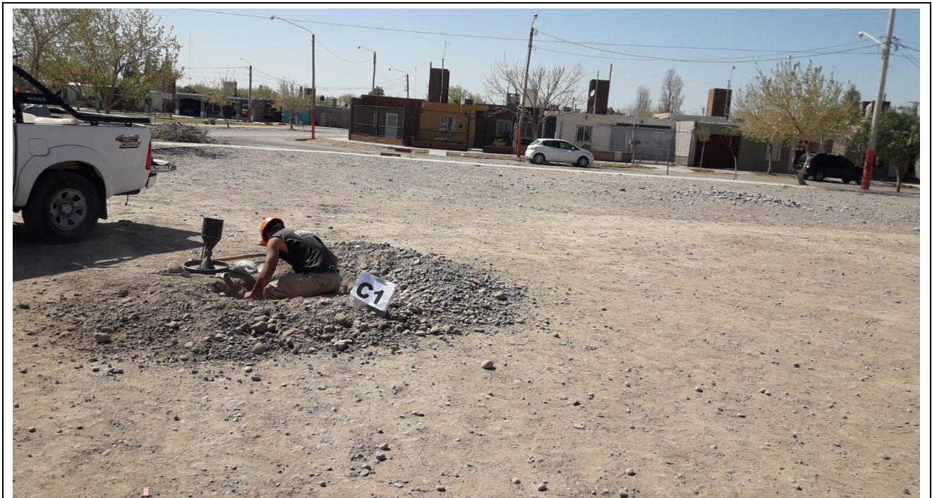
Fotografía N°3: Vista de la posición en el terreno de la Calicata C.1 . Se observan los trabajos de excavación y toma de muestra.
