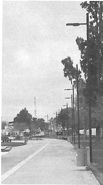
Imagen 1: Luminaria existente tipo "Kraken Ignis Lighting LED"
