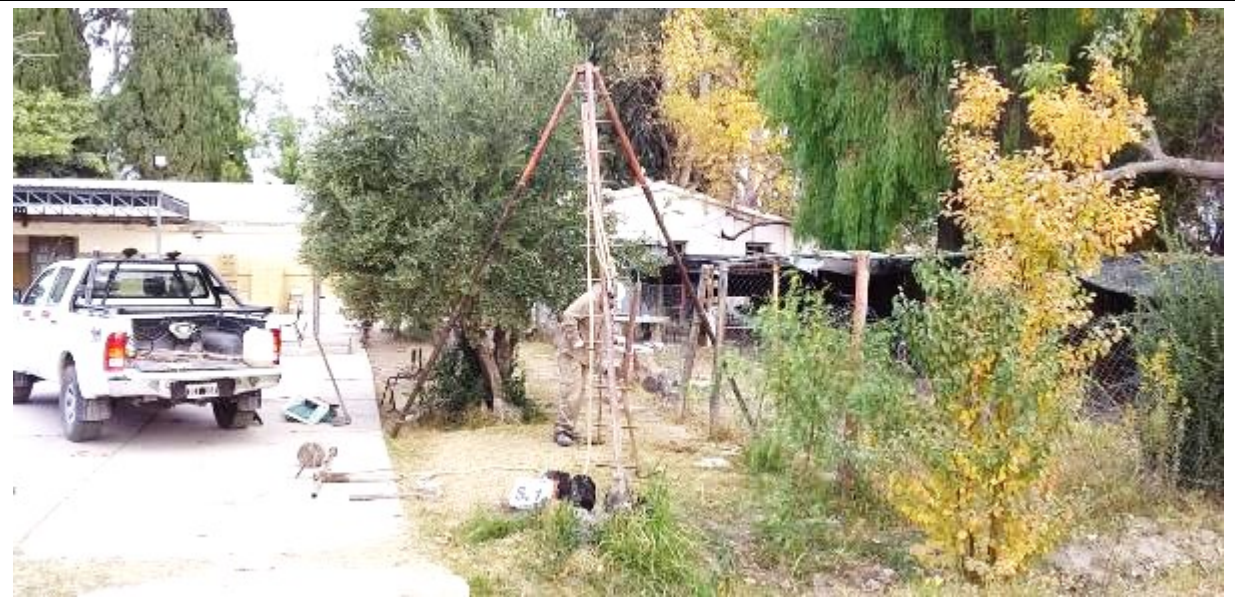
Fotografía N°7: Vista de la posición en el terreno del Sondeo S.1. Se observan los trabajos de perforación y toma de muestra, como así también el ensayo de penetración estándar (SPT).
