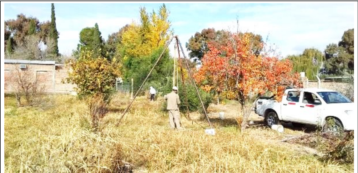
Fotografía N°13: Vista de la posición en el terreno del Sondeo S.3 . Se observan los trabajos de perforación y toma de muestra, como así también el ensayo de penetración estándar (SPT).
