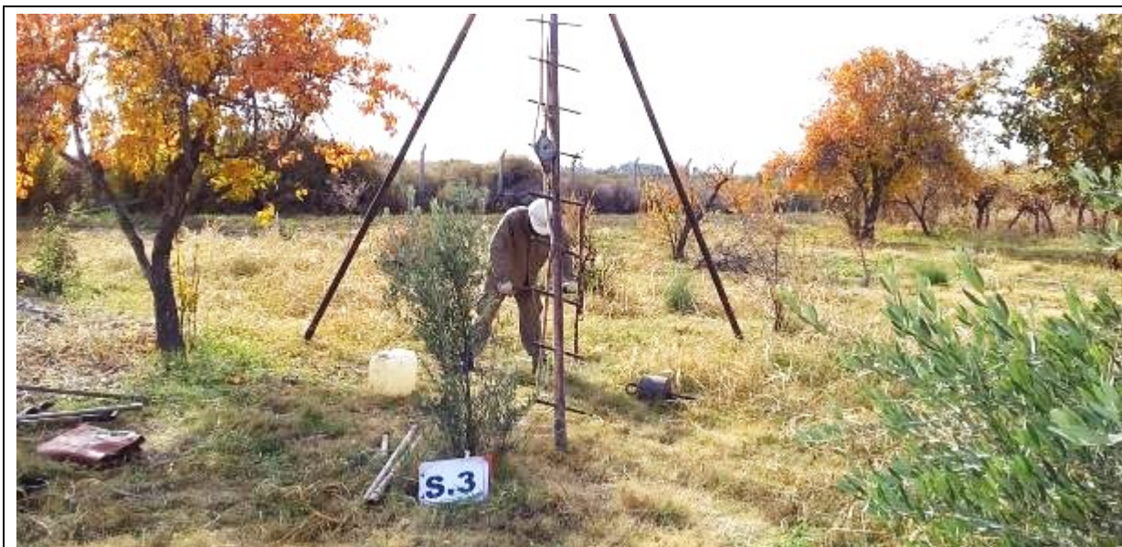
Fotografía N°15: Vista de la posición en el terreno del Sondeo S.3. Se observan los trabajos de perforación y toma de muestra, como así también el ensayo de penetración estándar (SPT).
