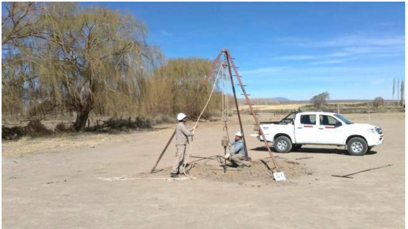
Fotografía N°7: Se muestra una vista de la posición del sondeo S.1 en el terreno estudiado. Se observan los trabajos de excavación y toma de muestra, como así también el ensayo de penetración estándar (SPT).
