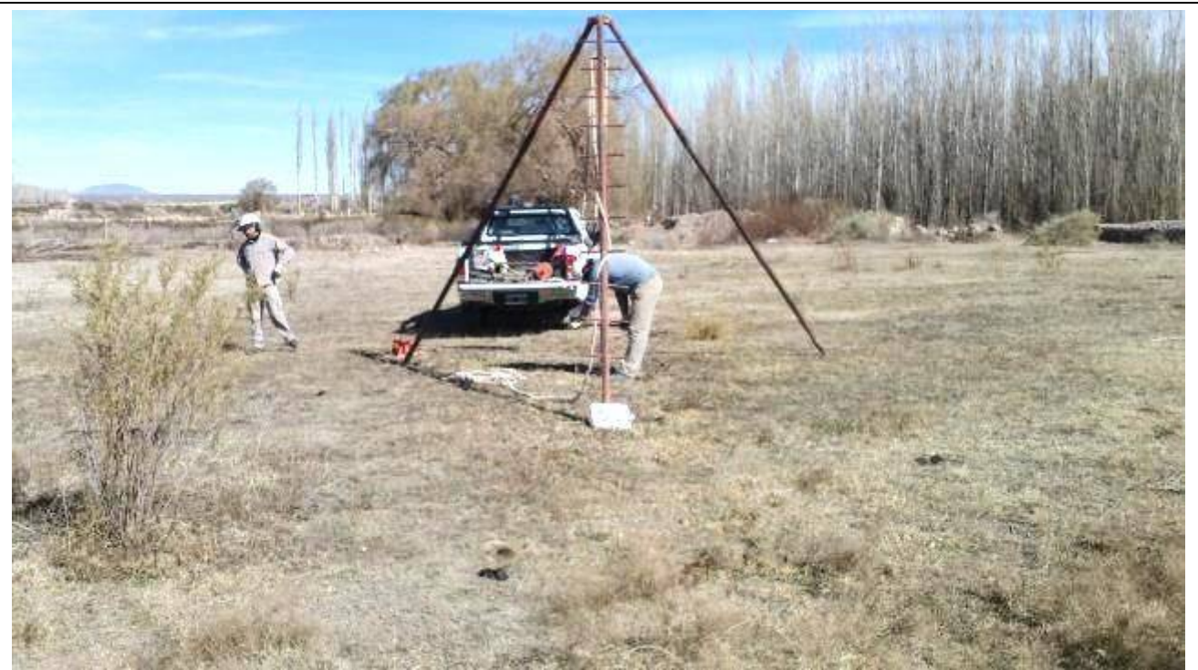
Fotografía N°9: Se muestra una vista de la posición del sondeo S.2 en el terreno estudiado. Se observan los trabajos de excavación y toma de muestra, como así también el ensayo de penetración estándar (SPT).
