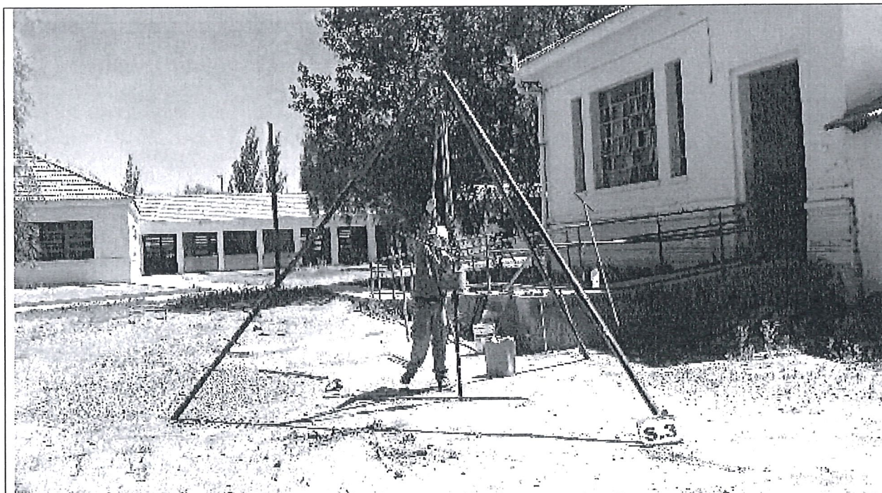
Fotografía N°18: Vista de la posición en el terreno del Sondeo S.3. Se observan los trabajos de perforación y toma de muestra, como así también el ensayo de penetración estándar (SPT).
