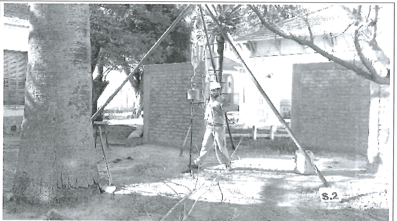
Fotografía N°12: Vista de la posición en el terreno del Sondeo S.2. Se observan los trabajos de perforación y toma de muestra, como así también el ensayo de penetración estándar (SPT).
