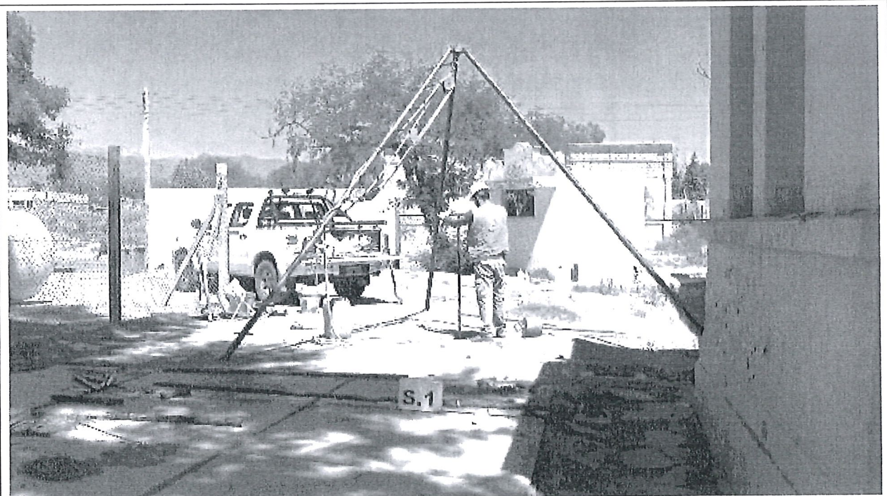
Fotografía N°6: Vista de la posición en el terreno del Sondeo S.1. Se observan los trabajos de perforación y toma de muestra, como así también el ensayo de penetración estándar (SPT).
