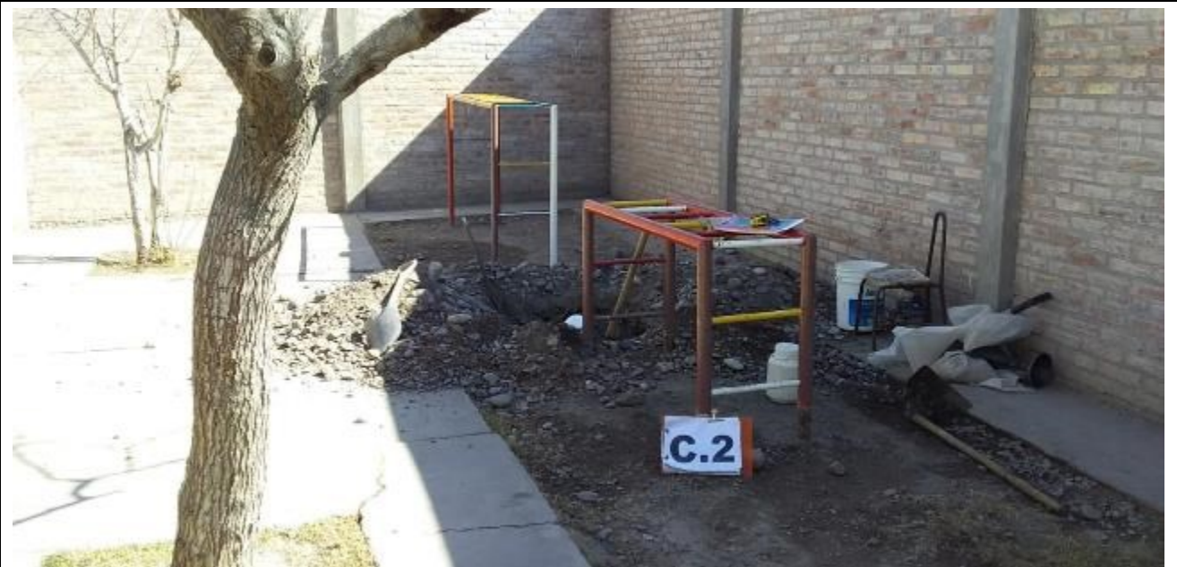
Fotografía N°15: Calicata C.2 . Se muestra la posición de la calicata ejecutada en el terreno estudiado, se observan los trabajos de excavación y toma de muestra.
