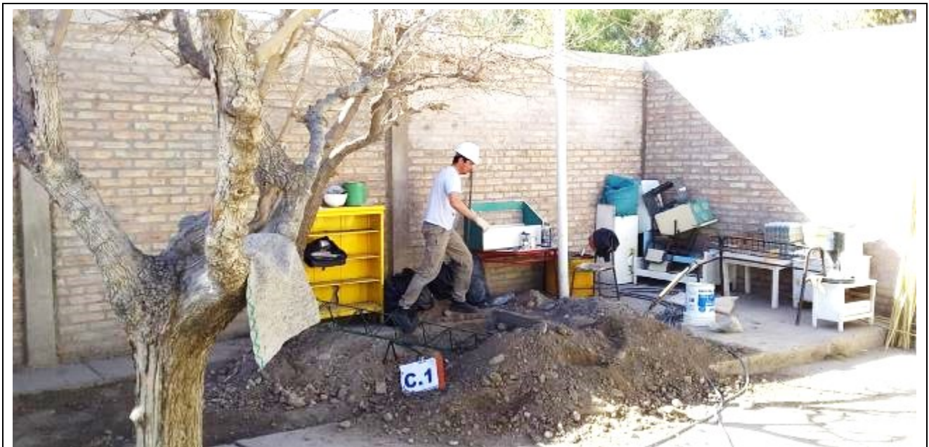
Fotografía N°7: Calicata C.1 . Se muestra la posición de la calicata ejecutada en el terreno estudiado, se observan los trabajos de excavación y toma de muestra.
