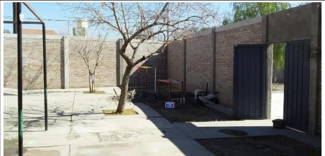
Fotografía N°13: Calicata C.2 . Se muestra la posición de la calicata ejecutada en el terreno estudiado, se observan los trabajos de excavación y toma de muestra.
