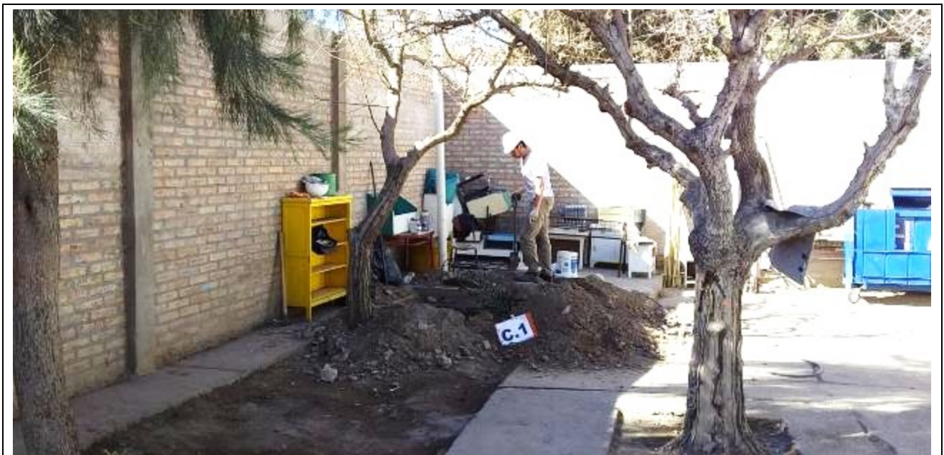
Fotografía N°8: Calicata C.1 . Se muestra la posición de la calicata ejecutada en el terreno estudiado, se observan los trabajos de excavación y toma de muestra.
