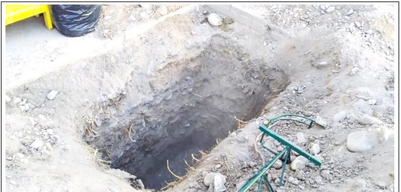
Fotografía N°10: Calicata C.1 . Se muestra la posición de la calicata ejecutada en el terreno estudiado, se observan los trabajos de excavación y toma de muestra.
