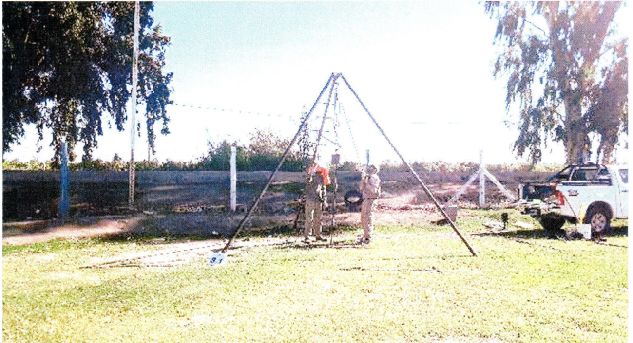
Fotografía N°7: Vista de la posición en el terreno del Sondeo S.1 . Se observan los trabajos de perforación y toma de muestra, como así también el ensayo de penetración estándar (SPT).
