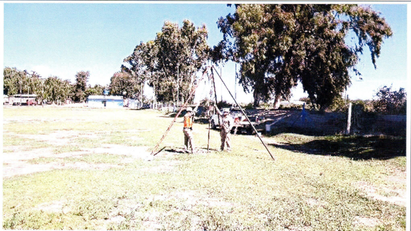
Fotografía N°18: Vista de la posición en el terreno del Sondeo S.4. Se observan los trabajos de perforación y toma de muestra.
