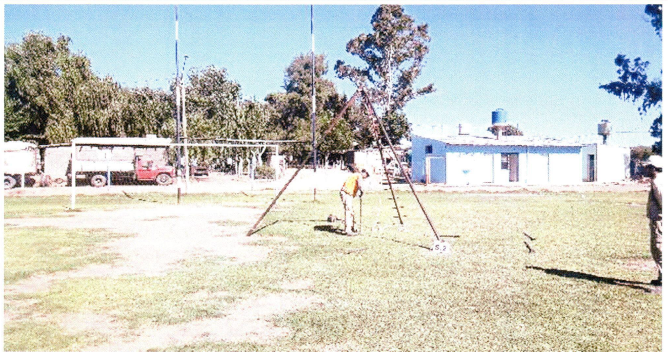
Fotografía N°9: Vista de la posición en el terreno del Sondeo S.2 . Se observan los trabajos de perforación y toma de muestra, como así también el ensayo de penetración estándar (SPT).
