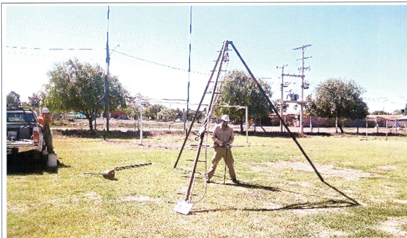
Fotografía N°13: Vista de la posición en el terreno del Sondeo S.3. Se observan los trabajos de perforación y toma de muestra.
