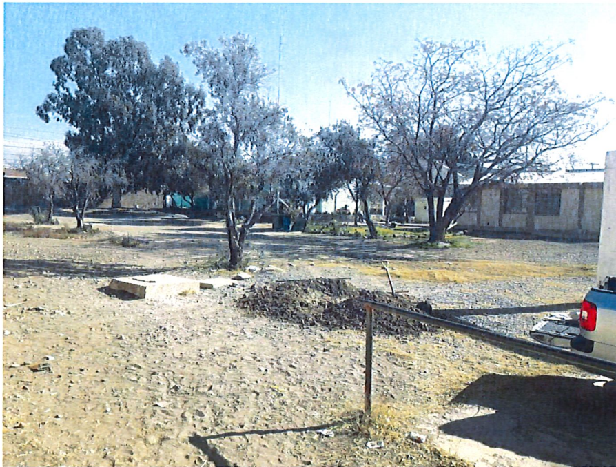
Fotografía N°12: Vista de la posición de la calicata C.2 en el terreno estudiado, se observan los trabajos de excavación.
