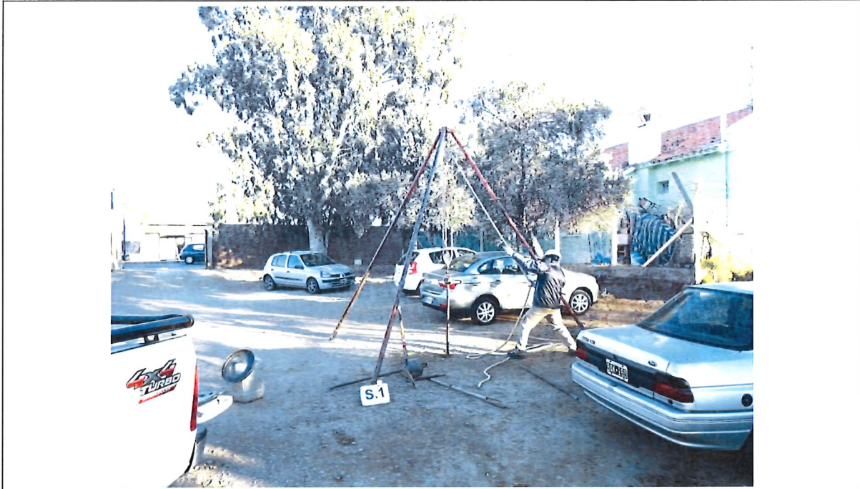
Fotografía N°17: Sondeo S.1. Se observa la posición en el terreno del mismo, y los trabajos de perforación y toma de muestra, como así también el ensayo de penetración estándar (SPT).
