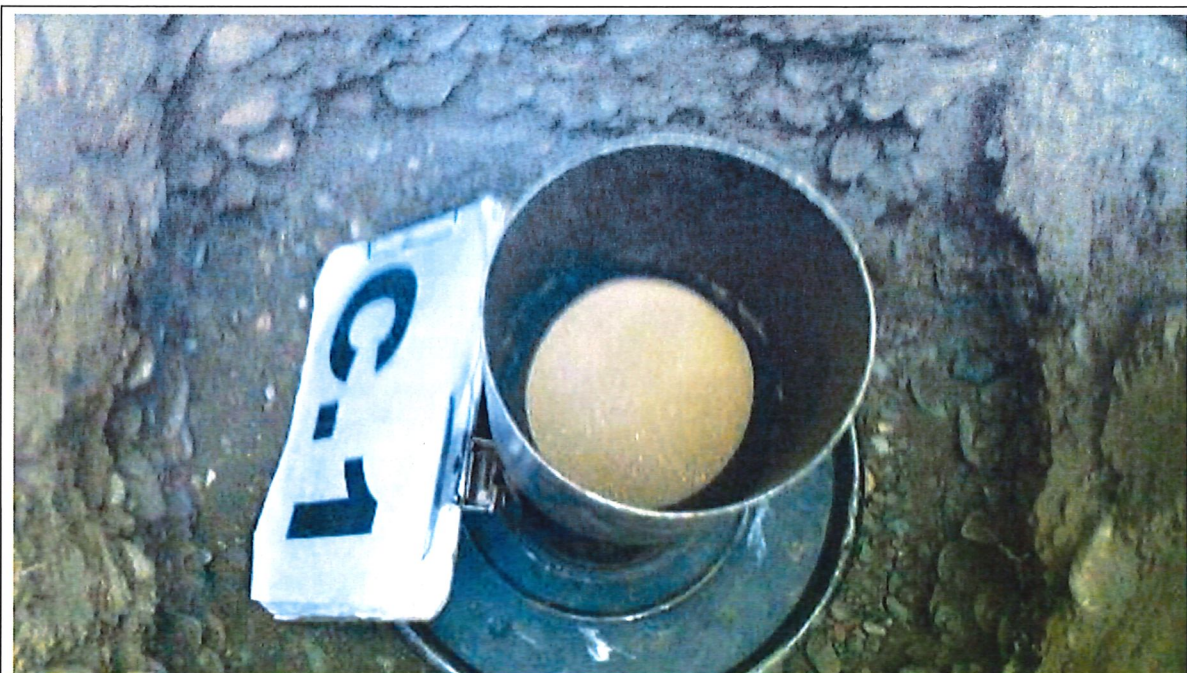
Fotografía N°8: Calicata C.1, se observa el ensayo de densidad in situ a la Prof. de 1,60m en el estrato subyacente de grava arenosas.
