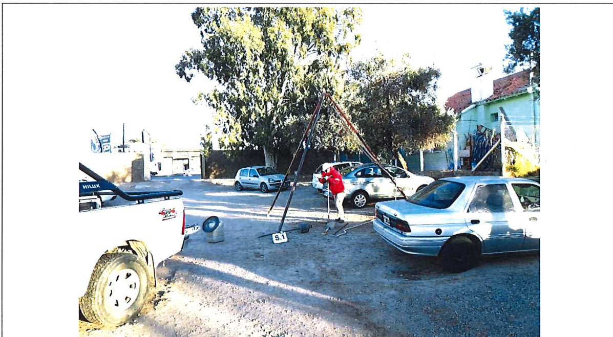
Fotografía N°16: Sondeo S.1. Se observa la posición en el terreno del mismo, y los trabajos de perforación y toma de muestra, como así también el ensayo de penetración estándar (SPT).
