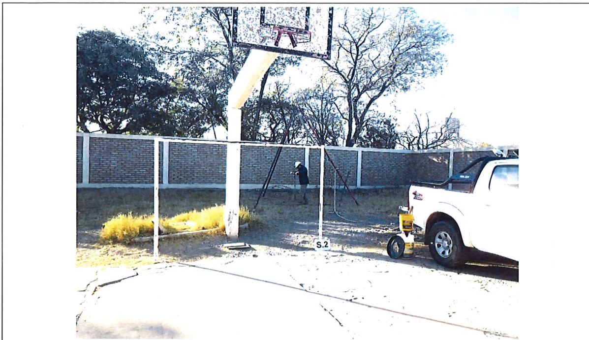
Fotografía N°19: Sondeo S.2. Se observa la posición en el terreno del mismo, y los trabajos de perforación y toma de muestra, como así también el ensayo de penetración estándar (SPT).
