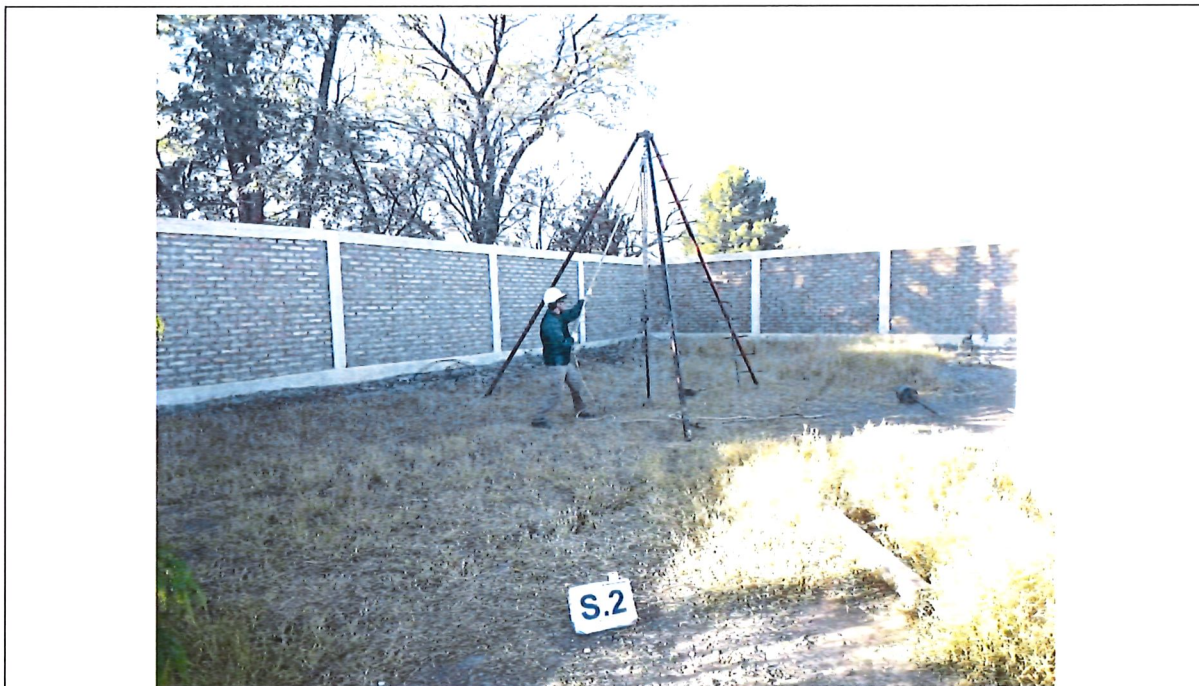
Fotografía N°21: Sondeo S.2. Se observa la posición en el terreno del mismo, y los trabajos de perforación y toma de muestra, como así también el ensayo de penetración estándar (SPT).
